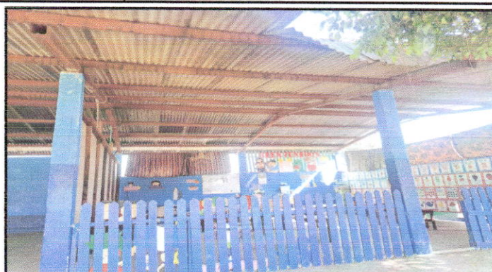
Foto 2: sustitucion de lamina por lamina troquelada calibre 26, y sustitucion de de soporte de metal por metal
